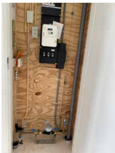
De gewone meterkast met de slimme meter, KPN-aansluiting, deurbel aansluiting, groepenkast en watermeter
