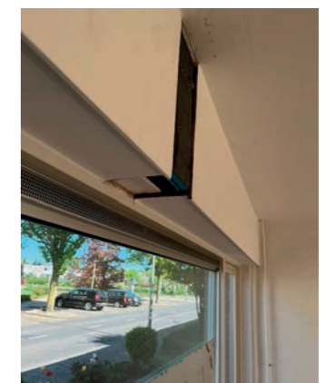
Opengewerkte koudebrug met isolatie
