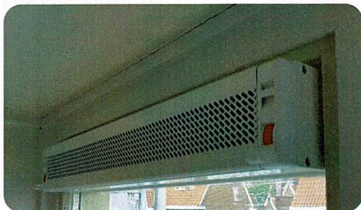
Rooster gesloten, geen ventilatie
