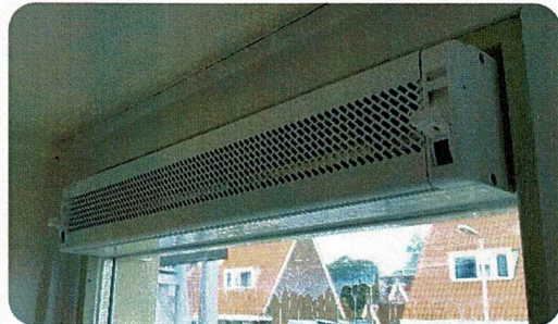
Rooster open, wel ventilatie
